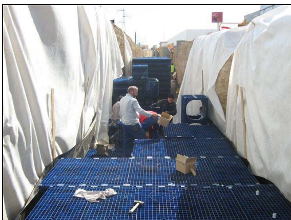
Figura 8. Depósito de Reutilización de pluviales formado por elementos reticulares. Zaragoza.
